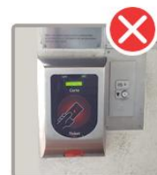
une borne d'accès aux ascenseurs du réseau TCL
